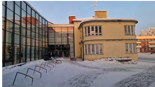
Kuva 6. Kauppakeskuksen ja Kukkolan talon liitoskohta.
